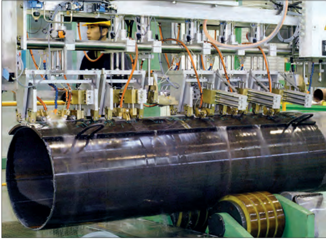
Акустические блоки системы контроля сварных соединений на сегменте трубы для калибровки системы (Фото предоставлено EEW-Корея)
